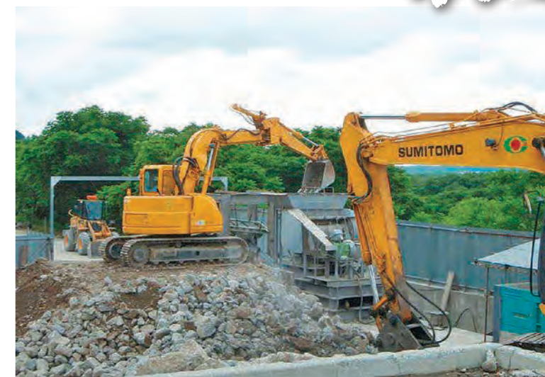
産業廃棄物中間処理施設
