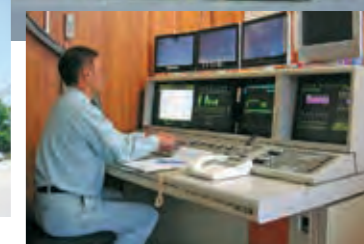
製造出荷制御室
